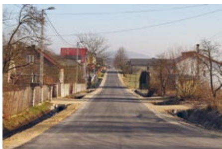
Remont drogi powiatowej w Dobrzeszowie. Odnowiono 270 m. nawierzchni oraz przylegające przepusty. Koszt to 31 tys. zł
