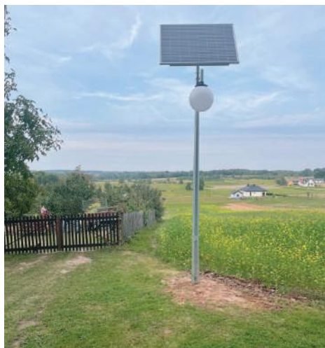
Zdjęcie lamp solarnych zamontowanych w sołectwie Nowek
