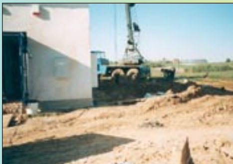
Stacja uzdatniania wody w Wielebnowie
